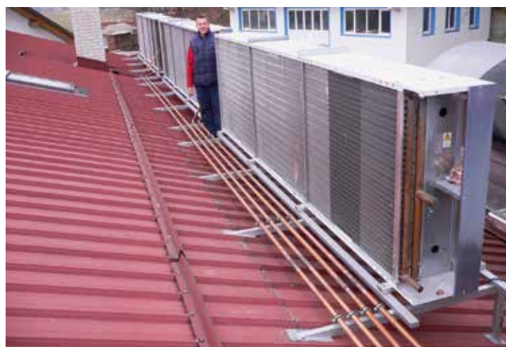
Toplotna črpalka ZRAK/VODA 800 kW.
